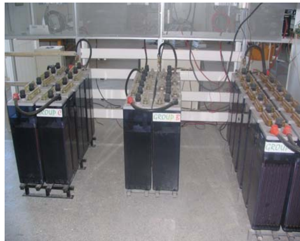
Εικόνα 4.6. Συστοιχία μπαταριών αποθήκευσης ενέργειας φωτοβολταϊκού εργαστηρίου
