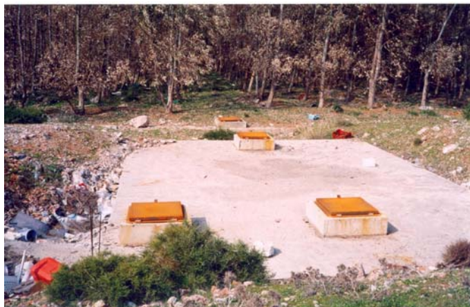
Φωτογραφία 4. Σηπτική δεξαμενή της μονάδας Πρασίνου
