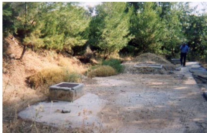
Φωτογραφία 21. Σηπτική δεξαμενή στη μονάδα του Αγ. Βλάση
