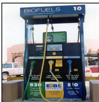
Εικόνα 22. Αντλίες υγρών βιοκαυσίμων
