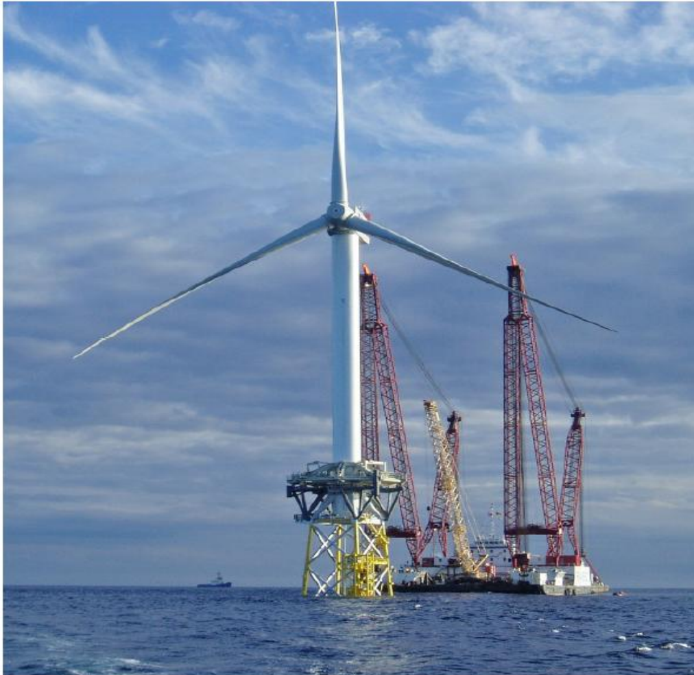
Ανεμογεννήτρια τύπου Repower 5M πάνω σε θεμέλιο τύπου Jacket Quattrorod της εταιρίας OWEC TOWER στο αιολικό πάρκο Beatrice στην Βόρεια Θάλασσα.
