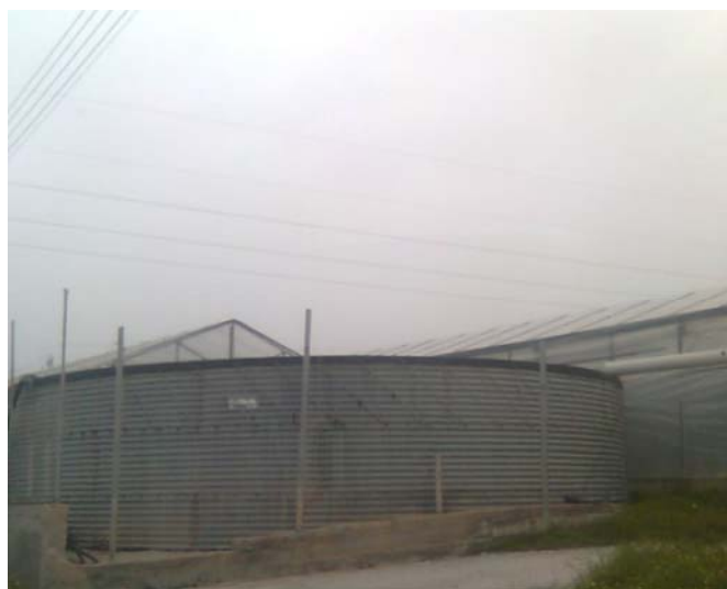
Εικόνα 7.18. Υπέργεια μεταλλική δεξαμενή
