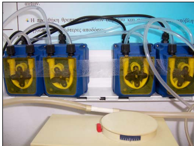
Εικόνα 12: Περισταλτικές (δοσομετρικές) αντλίες τροφοδοσίας
