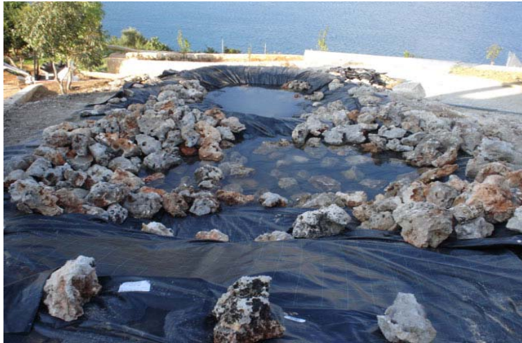
Εικόνα 59. Κάλυψη της κατασκευής του καταρράκτη με ελαστική μεμβράνη (pond liner) και τοποθέτηση πετρών πάνω της.
