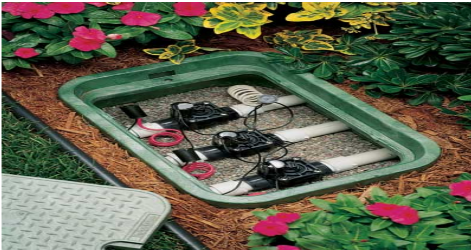
Εικόνα 68. Φρεάτιο με διανομείς νερού
