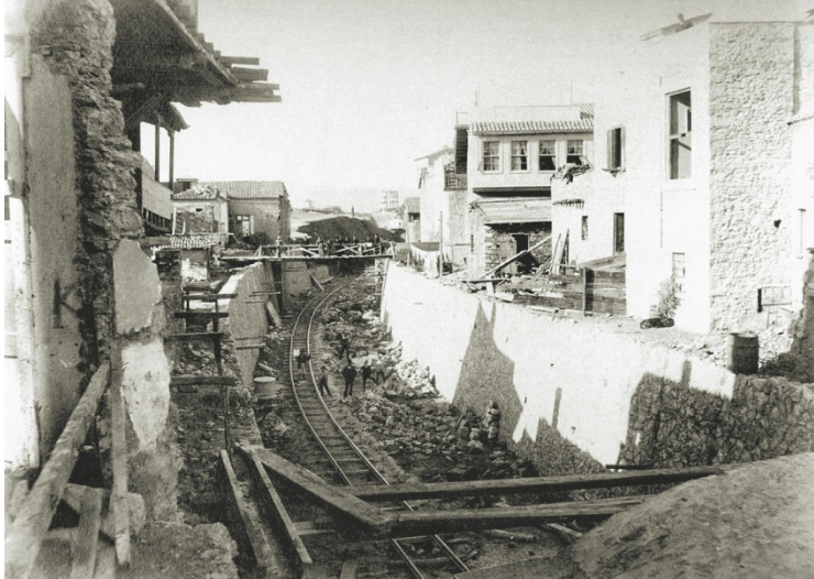
Έργα κατασκευής της γραμμής Θησείο - Μοναστηράκι - Ομόνοια γύρω στο 1890. Η σημερινή εμπλοκή στην ανακατασκευή των γραμμών του ΗΣΑΠ στο συγκεκριμένο κομμάτι έχει τις ρίζες της σε αυτές ακριβώς τις εργασίες.
