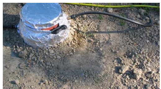
Εικ.11 Δεξαμενή νερού αυτόματου συστήματος ποτίσματος.
