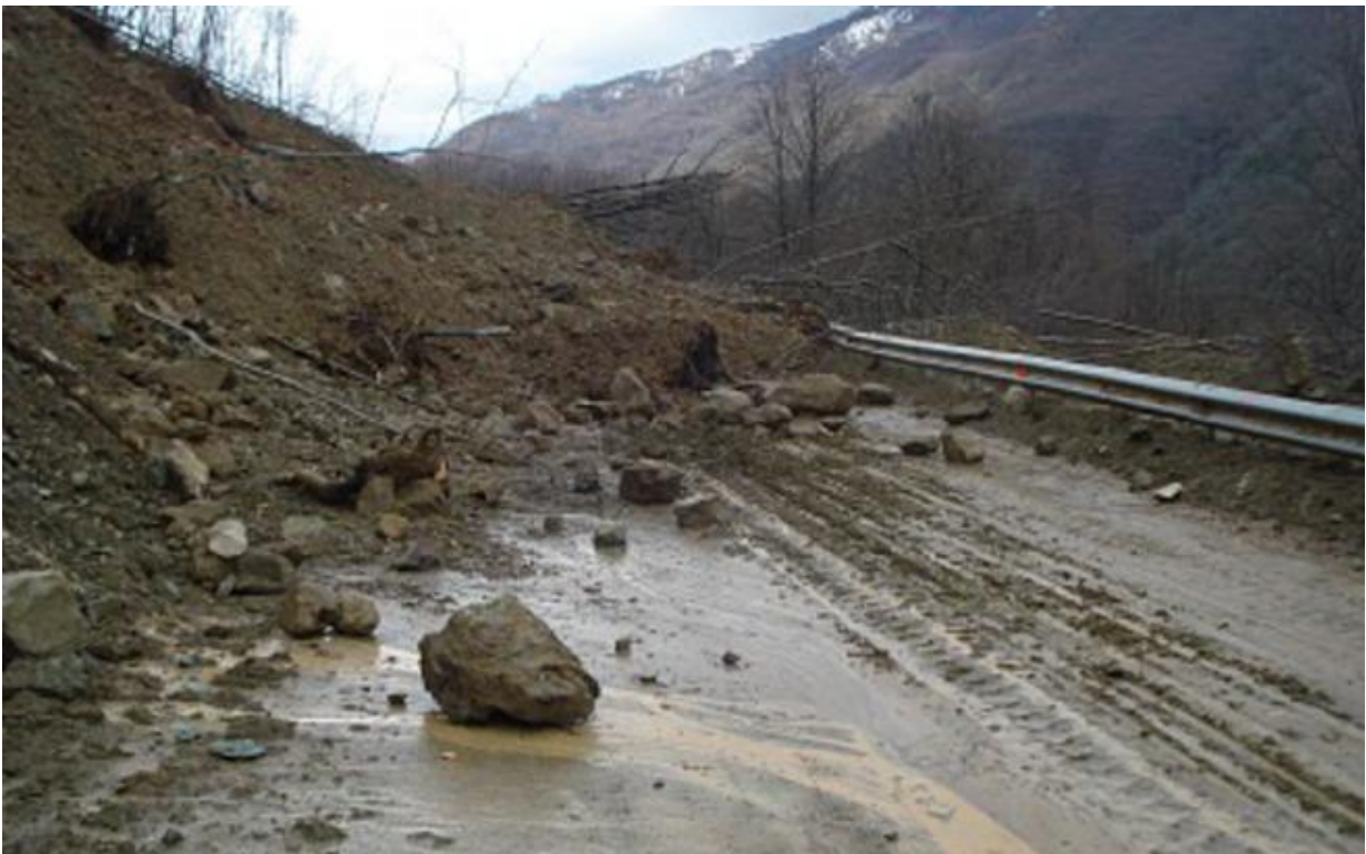
Εικόνα 5:Κατολίσθηση στο Ν. Ρεθύμνου στο δρόμο Γερακάρι – Σπήλι
