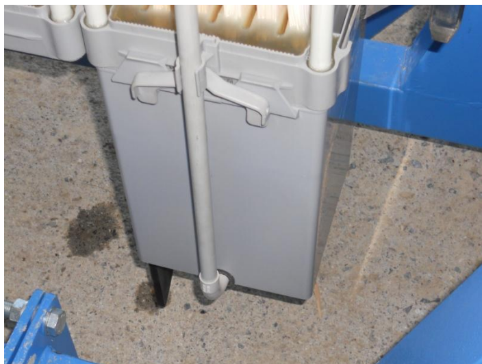
Εικόνα 19: Ειδικό τεμάχιο μετατροπής της συνεχούς ροής του αέρα σε διακοπτόμενη του συστήματος πλήσης των μεμβρανών της μονάδας MBR των εγκαταστάσεων επεξεργασίας λυμάτων του Δήμου Ηρακλείου.
