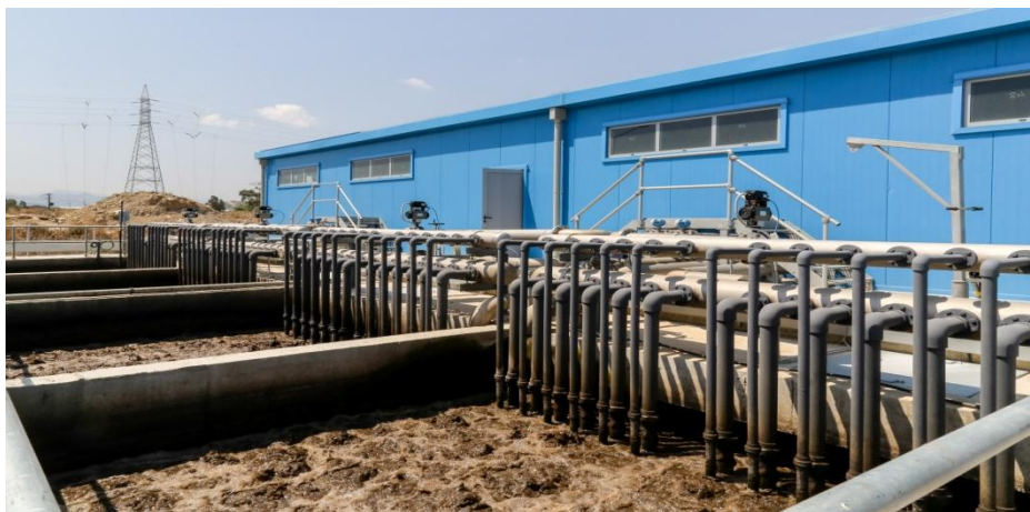
Εικόνα 14: Σύστημα μεμβρανών (Membrane Bioreactor-MBR της μονάδας MBR των εγκαταστάσεων επεξεργασίας λυμάτων του Δήμου Ηρακλείου
