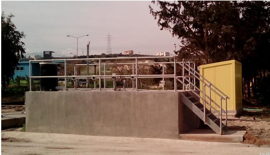
Εικόνα 7 : Αντλιοστάσιο εισόδου της μονάδας MBR των εγκαταστάσεων επεξεργασίας λυμάτων του Δήμου Ηρακλείου
