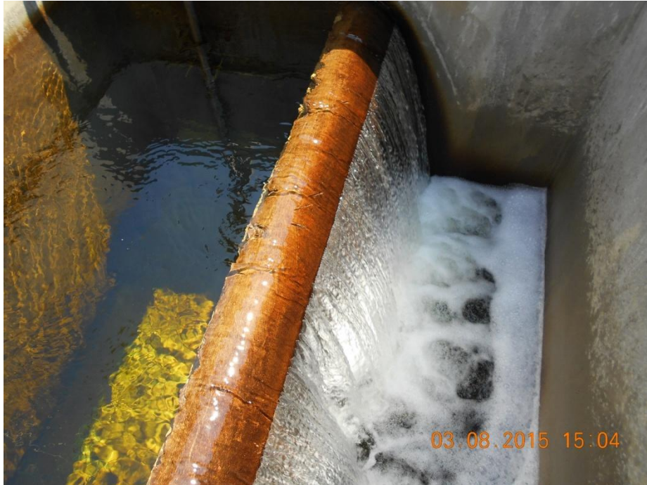
Εικόνα 31: Εκρόή της μονάδας MBR των εγκαταστάσεων επεξεργασίας λυμάτων του Δήμου Ηρακλείου.
