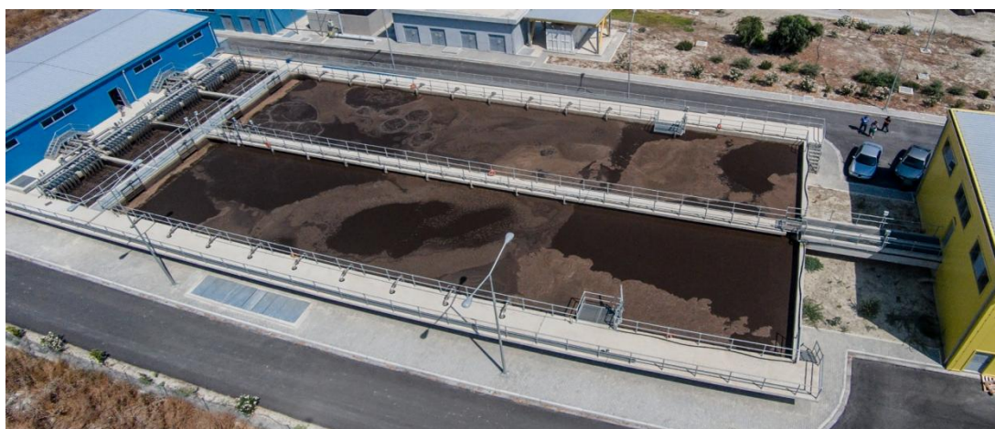
Εικόνα 13: Βιολογική επεξεργασία της μονάδας MBR των εγκαταστάσεων επεξεργασίας λυμάτων του Δήμου Ηρακλείου
