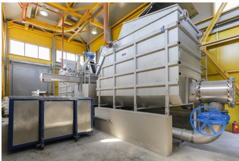
Εικόνα 9: Συγκρότημα λεπτοκοσκίνισης της μονάδας MBR των εγκαταστάσεων επεξεργασίας λυμάτων του Δήμου Ηρακλείου
