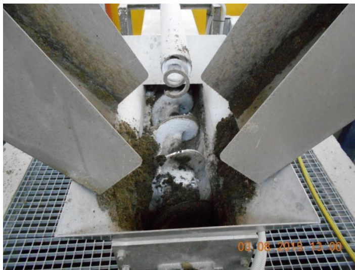
Εικόνα 10 : Συγκρότημα δοσομέτρησης της μονάδας MBR των εγκαταστάσεων επεξεργασίας λυμάτων του Δήμου Ηρακλείου
