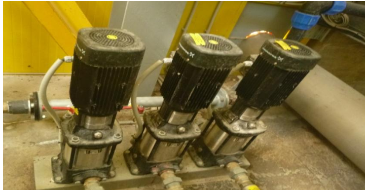
Εικόνα 11: Αντλητικό συγκρότημα για την πλύση των λεπτοκόσκινων της μονάδας MBR των εγκαταστάσεων επεξεργασίας λυμάτων του Δήμου Ηρακλείου
