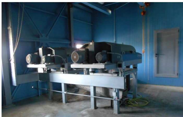
Εικόνα 25: Φυγοκεντρητές αφυδάτωσης ιλύος της μονάδας MBR των εγκαταστάσεων επεξεργασίας λυμάτων του Δήμου Ηρακλείου.
