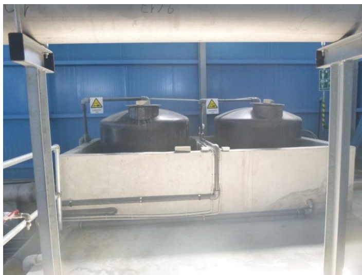
Εικόνα 20: Δεξαμενές χημικών συστήματος πλήσης των μεμβρανών της μονάδας MBR των εγκαταστάσεων επεξεργασίας λυμάτων του Δήμου Ηρακλείου.
