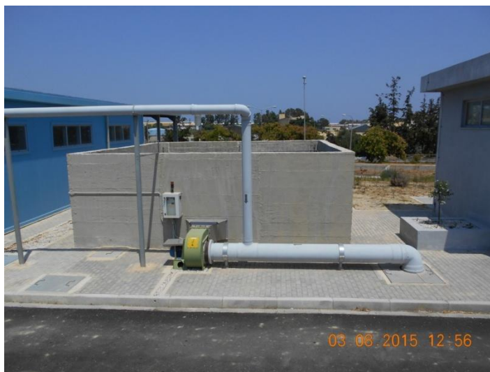
Εικόνα 26: Μονάδα απόσπησης της μονάδας MBR των εγκαταστάσεων επεξεργασίας λυμάτων του Δήμου Ηρακλείου.
