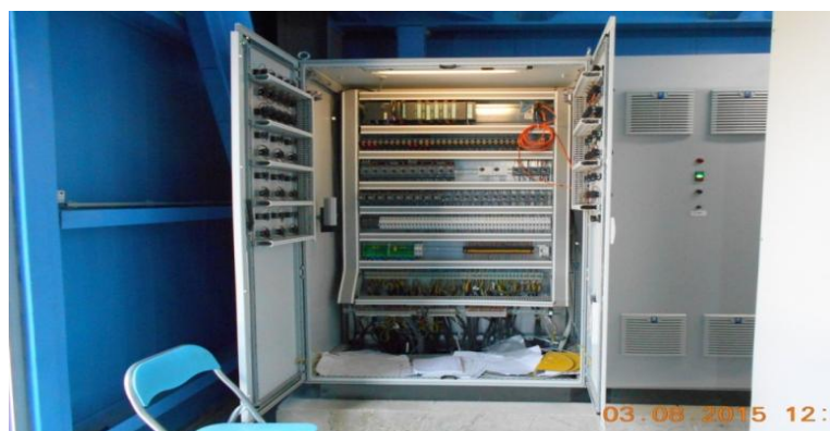
Εικόνα 28: Πίνακας αυτοματισμού της μονάδας MBR των εγκαταστάσεων επεξεργασίας λυμάτων του Δήμου Ηρακλείου.
