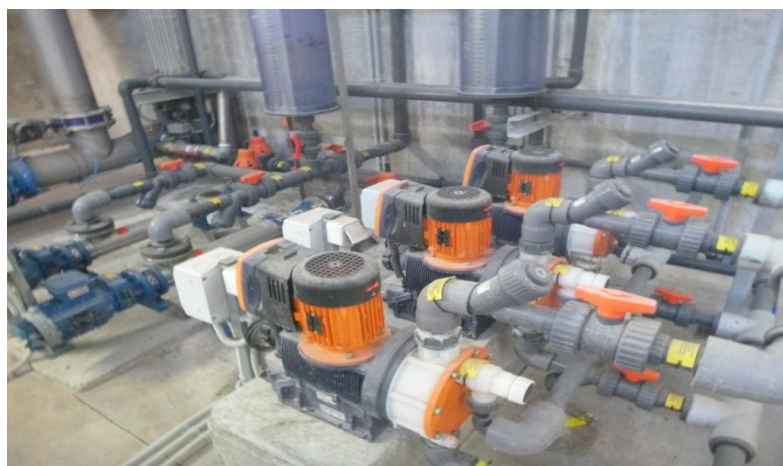
Εικόνα 21: Δοσομετρικές αντλίες χημικών πλήσης μεμβρανών της μονάδας MBR των εγκαταστάσεων επεξεργασίας λυμάτων του Δήμου Ηρακλείου.
