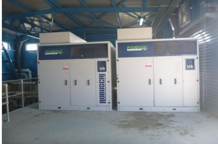
Εικόνα 23: Φυσητήρες της μονάδας MBR των εγκαταστάσεων επεξεργασίας λυμάτων του Δήμου Ηρακλείου.
