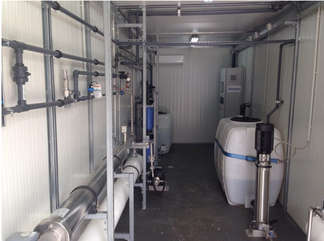
Εικόνα 5.8: Χώρος επεξεργασίας υγρών αποβλήτων.
