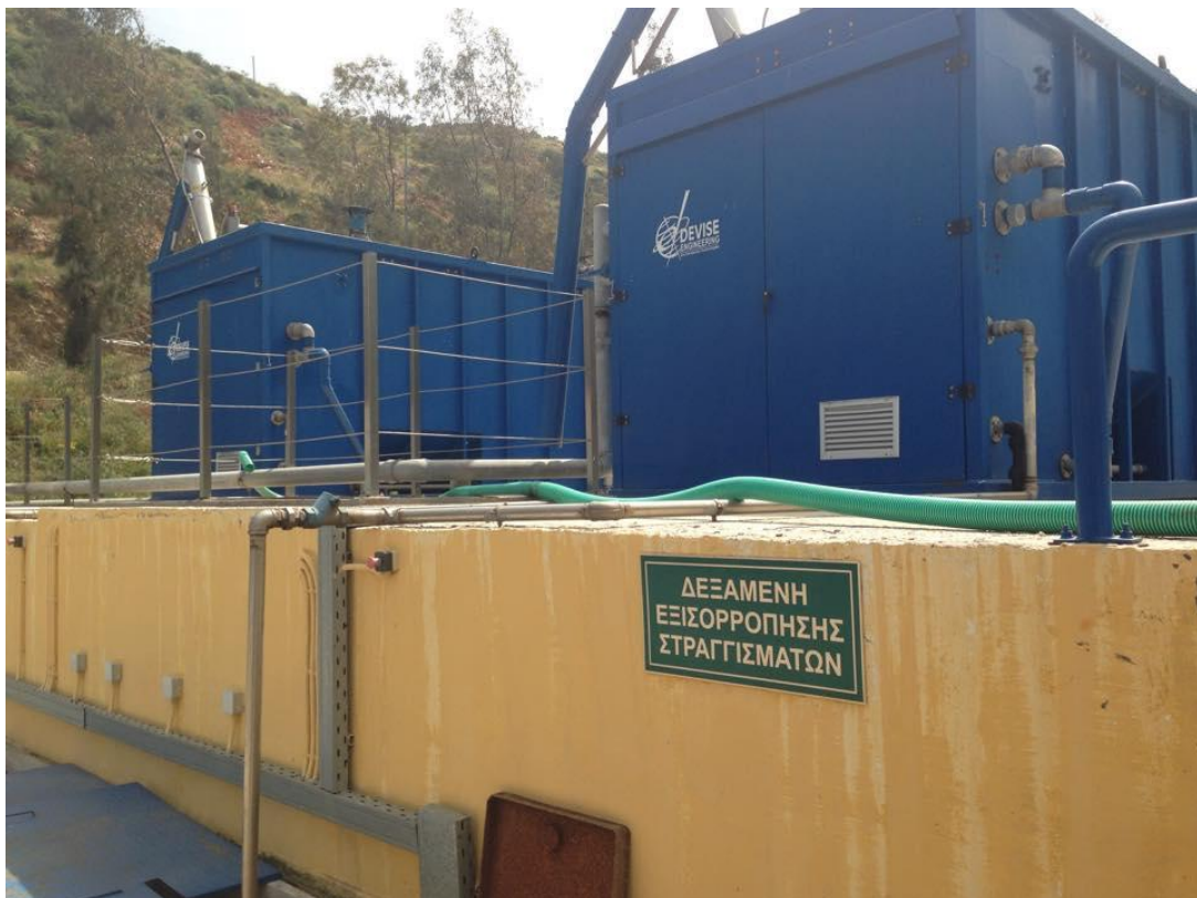
Εικόνα 5.7: Χώρος βιολογικού καθαρισμού (Δεξαμενή εξισορρόπησης στραγγισμάτων)
