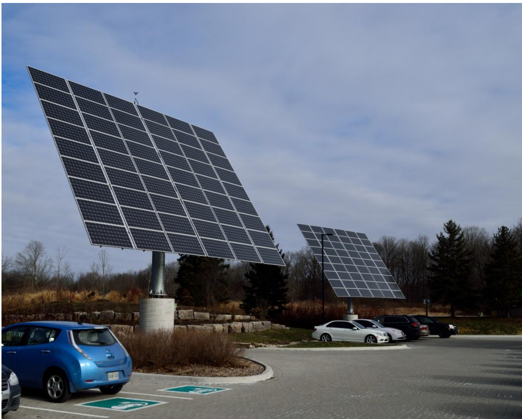
Εικόνα 12: φωτοβολταϊκός σταθμός φόρτισης ηλεκτρικών αυτοκινήτων
