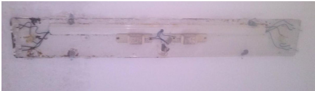
Εικόνα 6.5: Ακυρωμένο φωτιστικό σώμα.
