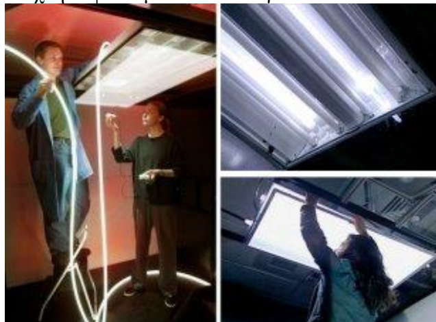
Εικόνα 4.13: Υβριδικά φωτιστικά σώματα.
