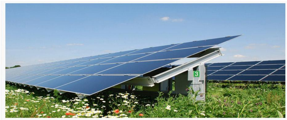
Εικόνα 34 Μονάδα παραγωγής ηλεκτρικού ρεύματος με φωτοβολταϊκά πάνελ.
