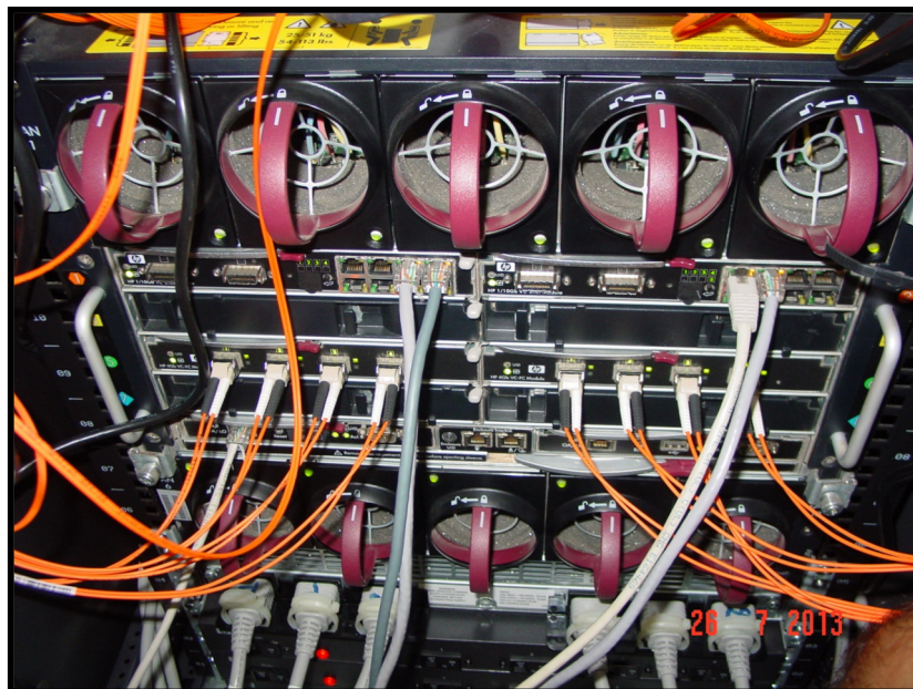
Εικόνα 23. HP BladeSystem c7000,πάνω προς τα κάτω: 5 Active Cool 200 Fan, 2 HP 1/10Gb VC-Enet Module, 2 HP 4Gb VC-FC Module, 2 BladeSystem c7000 Onboard Administrator.
