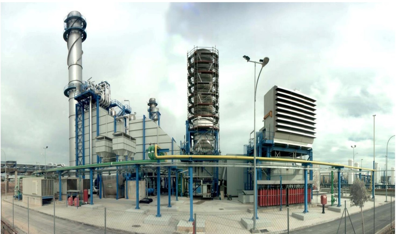
Σχήμα 3.1.4 Σταθμός παραγωγής ηλεκτρικής ενέργειας coal and gas της Iberdrola στην Μαδρίτη, Ισπανία.
