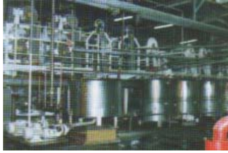
Εικ.13.14 Διηθητικό συγκρότημα χυμού Και δεξαμενές υποδοχής.
