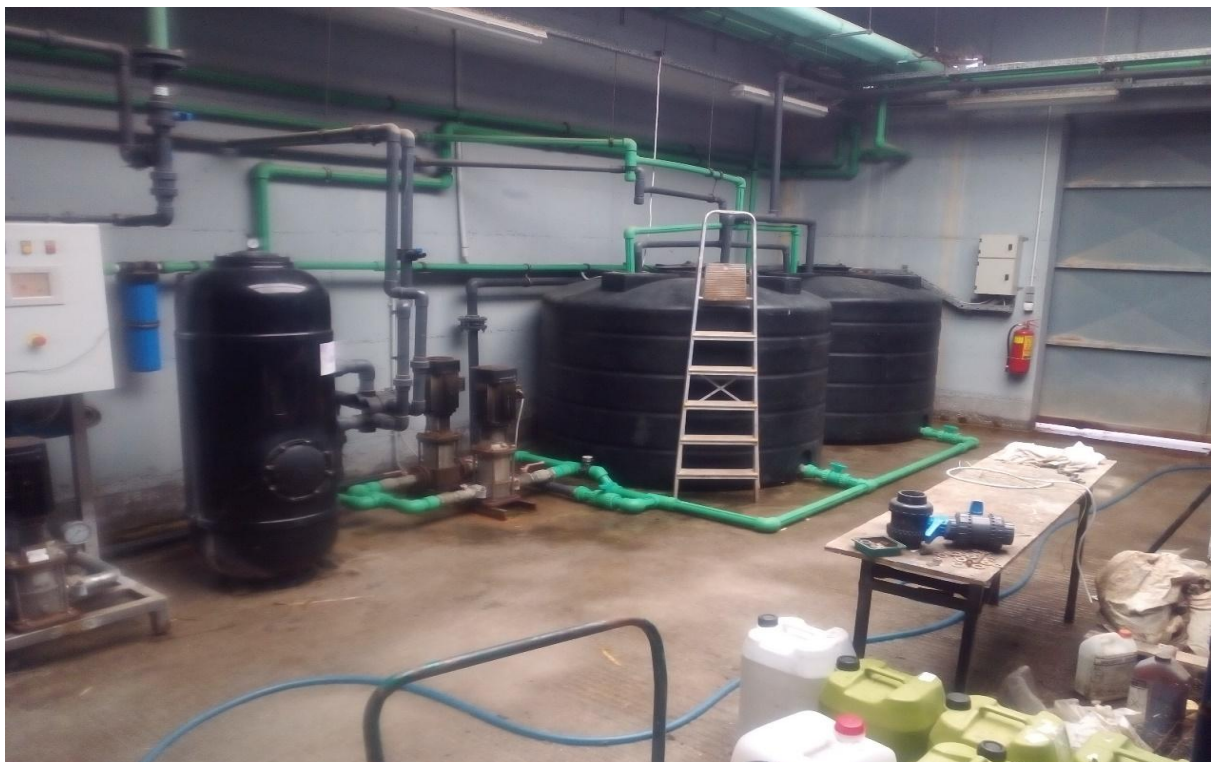
Εικόνα 8.1.1 Δεξαμενές αποθήκευσης αφαλατώσεων
