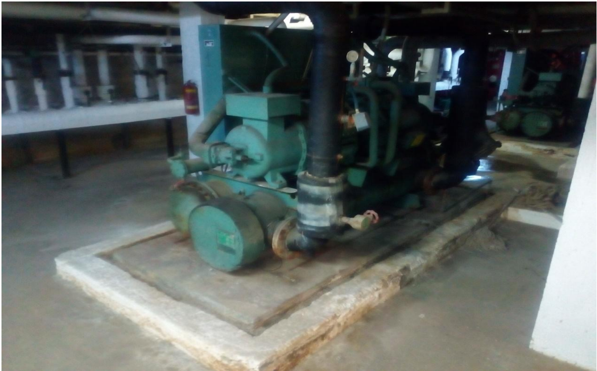
Εικόνα 13.3.1 1 ο Chiller ψύξεως
