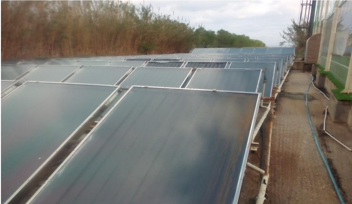
Εικόνα 6.1.3 Τρίτο ηλιακό πεδίο
