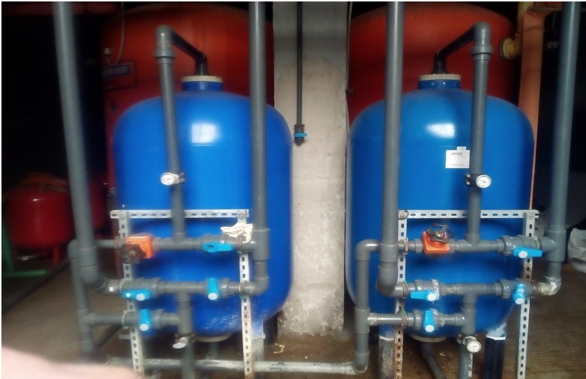
Εικόνα 7.1.2 Αμμόφιλτρα μεγάλης αφαλατικής εγκατάστασης
