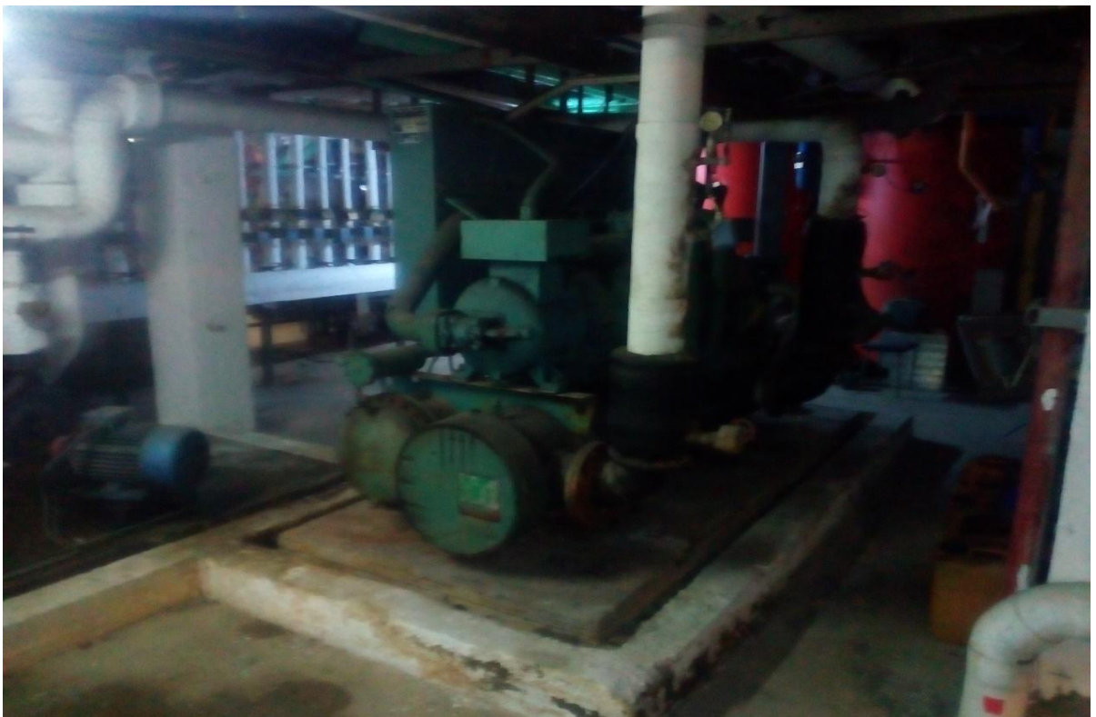
Εικόνα 13.3.2 2 ο Chiller ψύξεως
