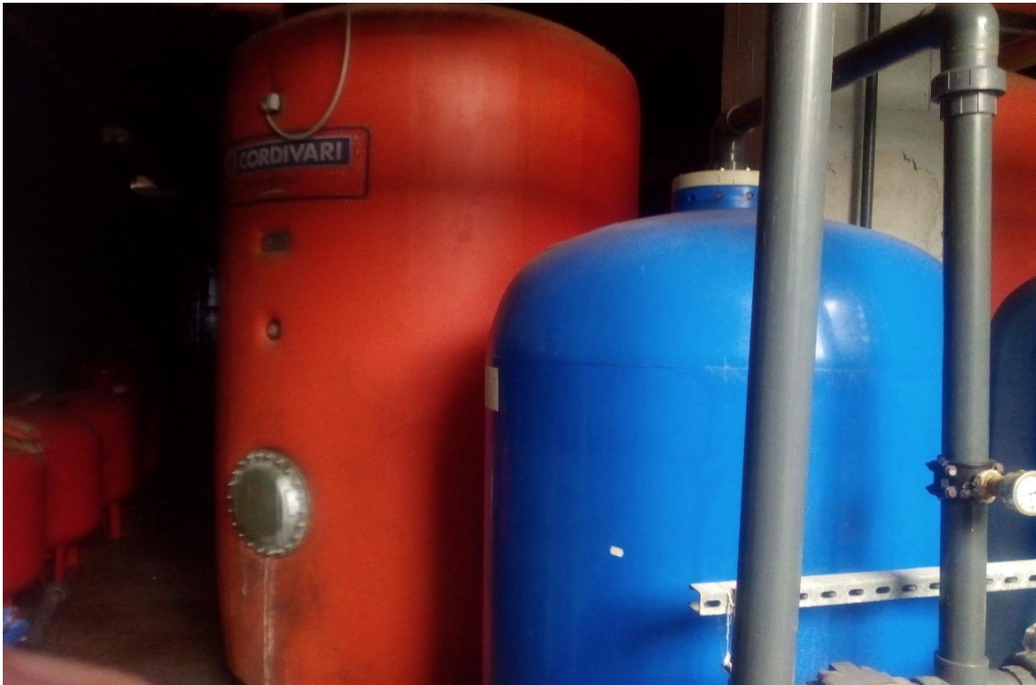
Εικόνα 6.1.5 Θερμοδοχεία ζεστού νερού ηλιακών πεδίων
