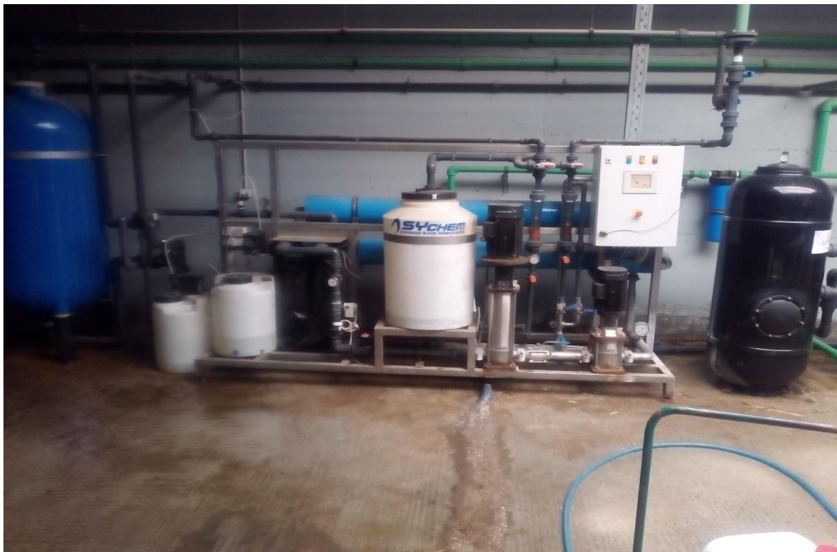
Εικόνα 8.1 Μικρή αφαλατική εγκατάσταση
