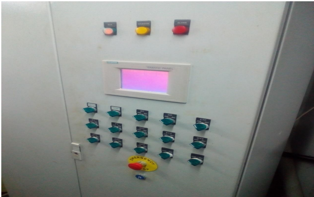
Εικόνα 7.1.1 Πίνακας ελέγχου εξοπλισμού
