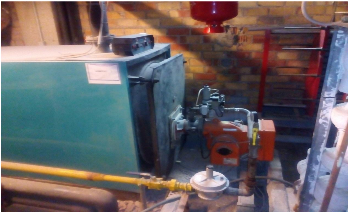
Εικόνα 11.3 Λέβητας υγραερίου Global 500
