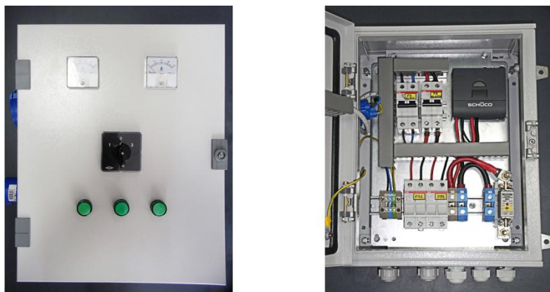
Εικόνα 3.12 Πίνακας αυτόνομου φωτοβολταϊκού συστήματος DC800
