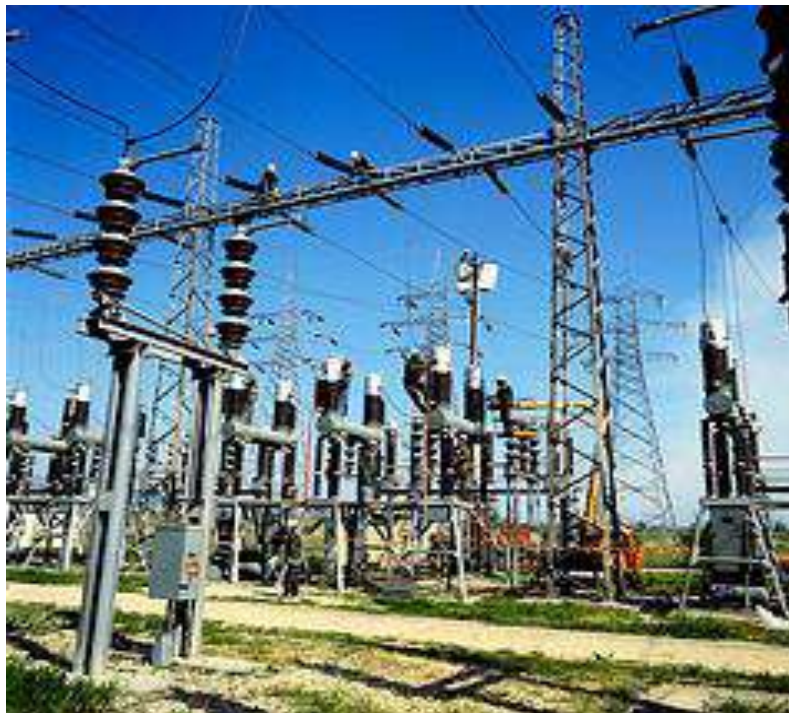
Εικόνα 19: Τυπικός υποσταθμός υψηλής τάσης 50.000 KVA, 150/21 kV.
