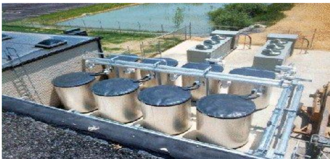
Σχήμα No.23: Δεξαμενές πάγου εγκαταστημένες στο Ινστιτούτο Τεχνολογίας του Dundalk.
