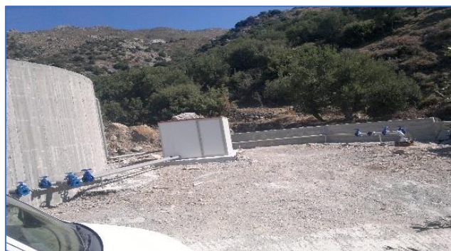
Εικόνα 3.3: Αντλιοστάσιο με δεξαμενή περιοχή Ανω Βιαννος
