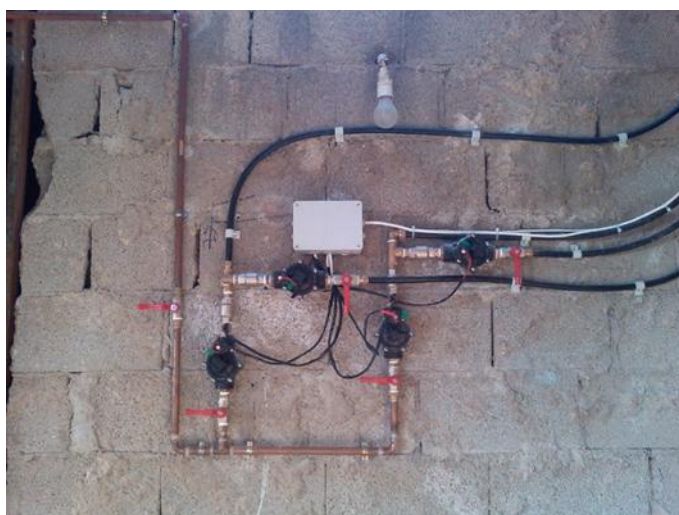
Εικόνα 3.10 Ηλεκτροβάνες και ροόμετρα για τα διαμερίσματα Δ3, Δ4
