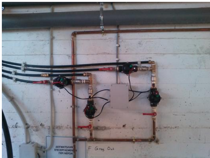
Εικόνα 3.9 Ηλεκτροβάνες και ροόμετρα για τα διαμερίσματα Δ1, Δ2
