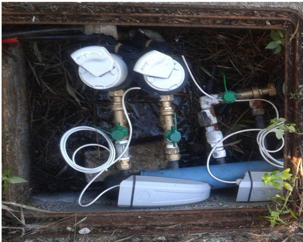
Εικ. 2.9: Έξυπνοι μετρητές νερού σε δίκτυο ύδρευσης
