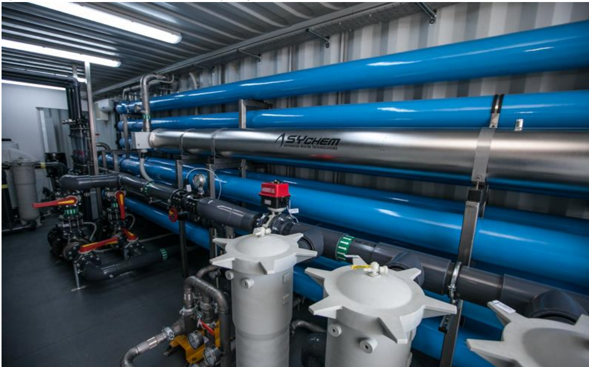
Εικόνα 25: Μεμβράνες Αντίστροφης Ώσμωσης στην εγκατάσταση του Αλμυρού
