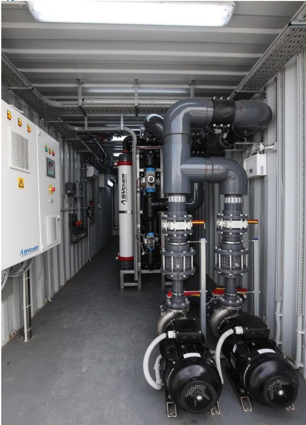
Εικόνα 24: Σύστημα προκατεργασίας νερού και αντλίες τροφοδοσίας υψηλής πίεσης.
