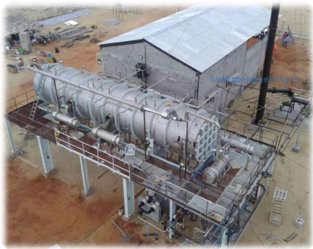
Εικόνα 13: Εγκατάσταση VC στο Ramnad της Ινδίας.[8]
