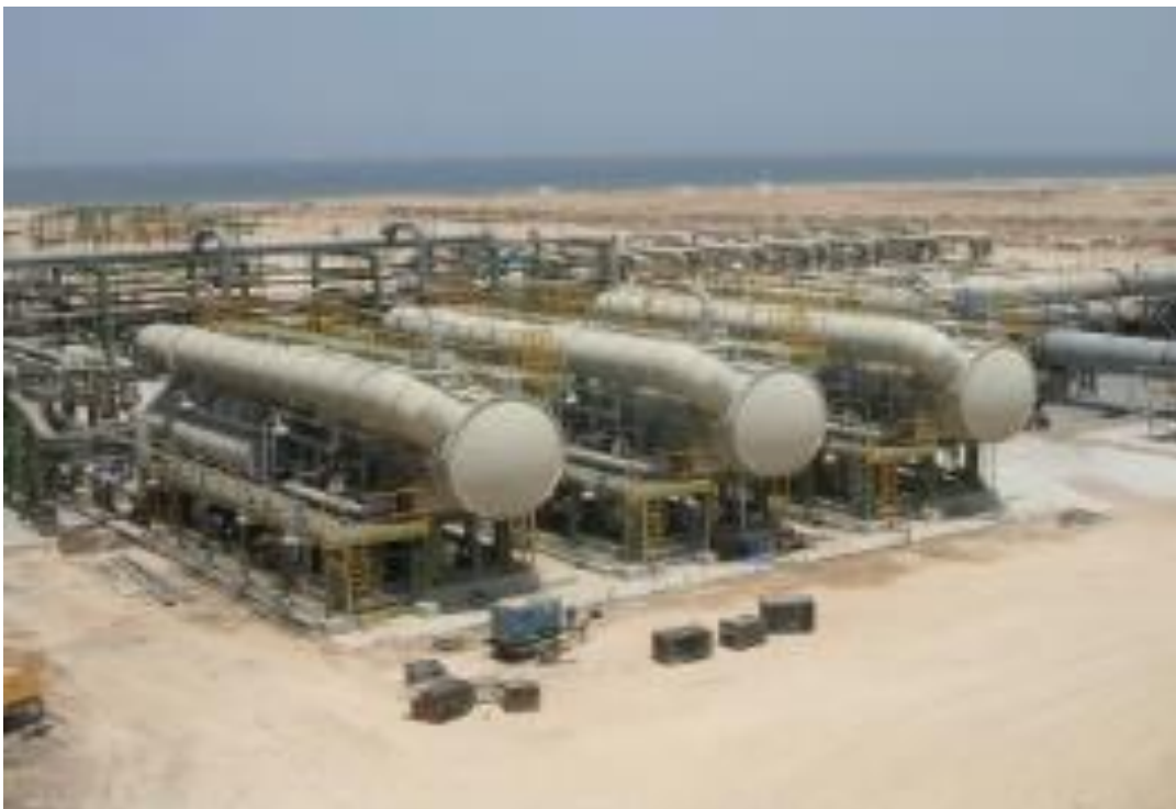
Εικόνα 12: Εγκατάσταση MED στο Ομάν.[8]
