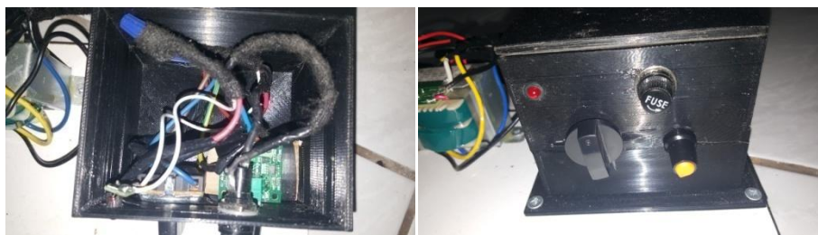
Εικόνα 74: Το εσωτερικό και το εξωτερικό του πίνακα οργάνων.
