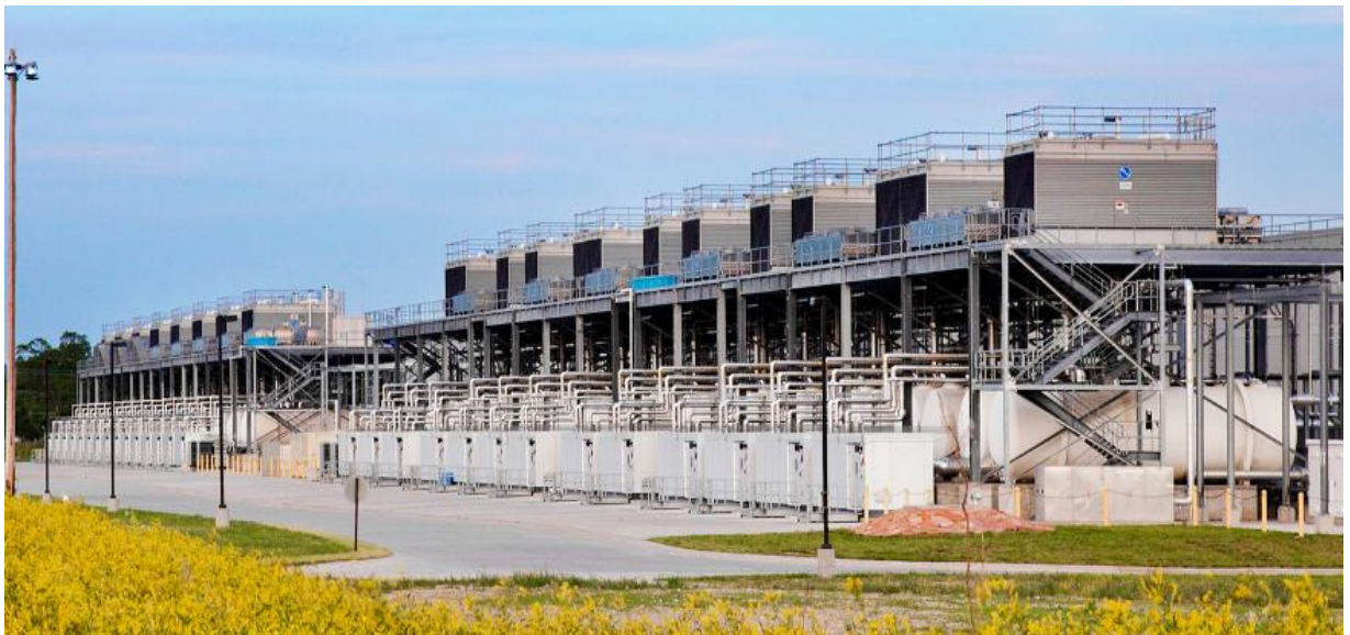
Εικόνα 1 Πύργοι ψύξης στο κέντρο δεδομένων της Google στο Council Bluffs, Iowa
