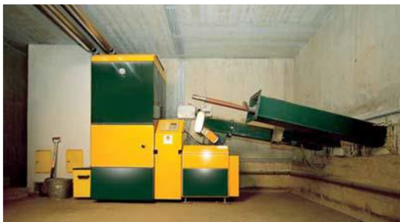
Εικόνα 51 : Τροφοδοσία λέβητα από αυτόματο κοχλία
