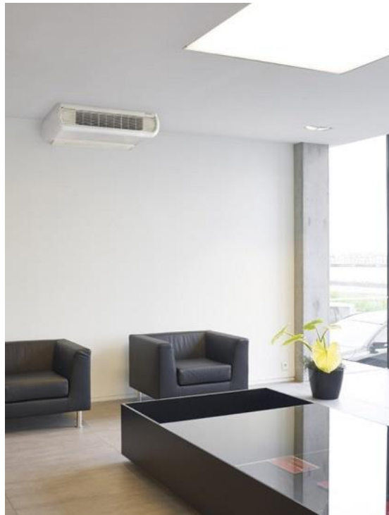
Εικόνα 75: Fan coil (εμφανής) οροφής, πάνω αριστερά
