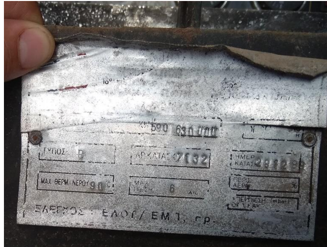
Εικόνα 155 : Ταμπελάκι κατασκευαστή λέβητα
