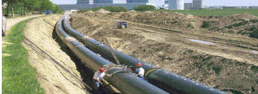
Εικόνα 63 : Αγωγός μεταφοράς τηλεθέρμανσης
