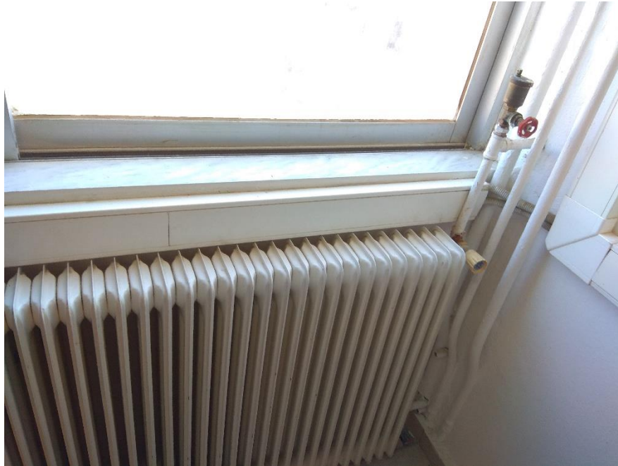
Εικόνα 66 : Θερμαντικό σώμα με παροχή νερού από δισωλήνιο σύστημα (κατακόρυφοι σωλήνες δεξιά)
