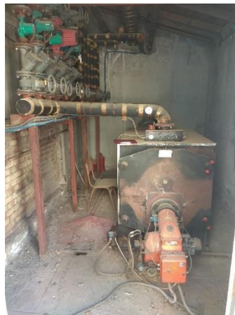
Εικόνα 154 : Λέβητας πετρελαίου στο λεβητοστάσιο του ΤΕΙ
