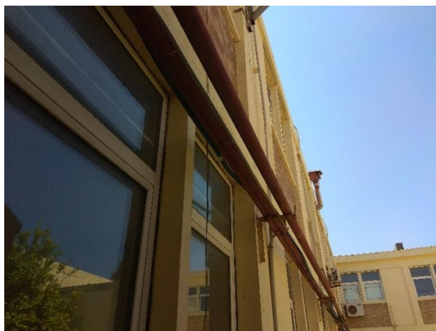
Εικόνα 68: Δισωλήνιο σύστημα διανομής με ανεπαρκή μόνωση (σχεδόν καθόλου)
