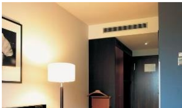
Εικόνα 76 : Fan coil «καναλάτο», σε δωμάτιο ξενοδοχείου
