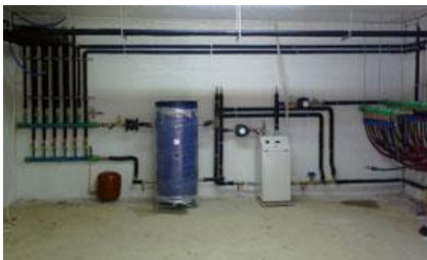
Εικόνα 88 : Αντλίας θερμότητας νερού/ νερού
