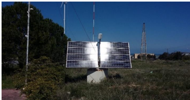
Εικόνα 4.4: Φωτοβολταϊκό πάνελ βιοκλιματικής κατοικίας.
