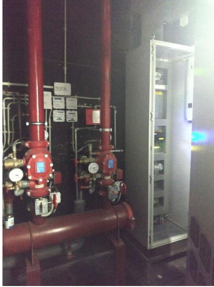
Εικόνα 10 - σύστημα πυρασφάλειας και rack ηλεκτρονικών
