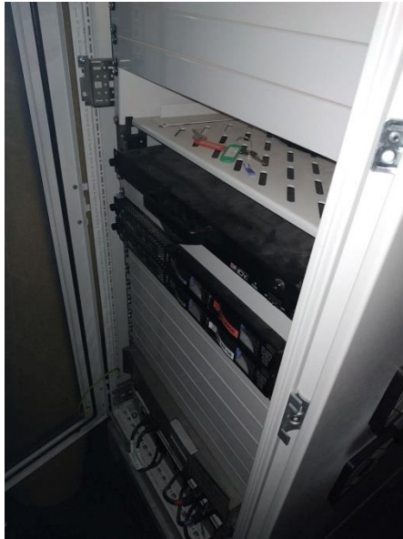
Εικόνα 12-rack ηλεκτρονικών και server σκηνής
