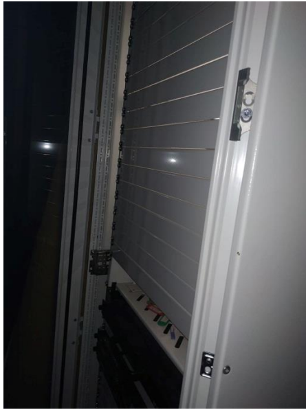
Εικόνα 14-rack ηλεκτρονικών και server σκηνής
