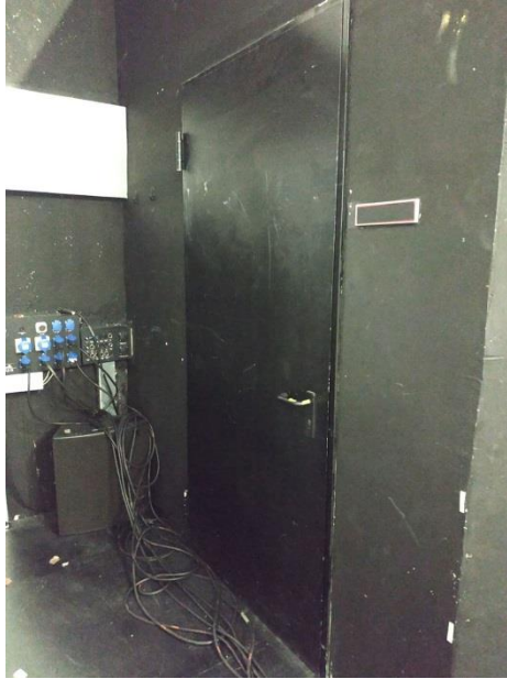
Εικόνα 6-το δωμάτιο ηλεκτρονικών εγκαταστάσεων
