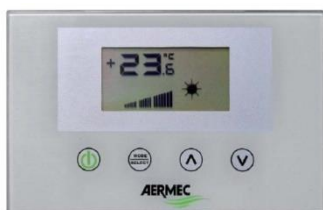
Σχήμα 5.9 : Χειριστήριο επιτοίχιο (θερμοστάτης) ενσύρματο, για την λειτουργία των Fan Coil [21]
