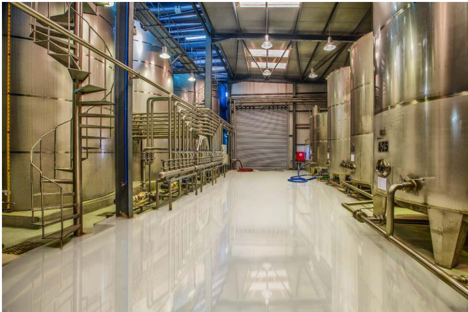
Εικόνα 5. Χώρος αποθήκευσης ελαιολάδου από τις εγκαταστάσεις της Ε.Α.Σ. Ηρακλείου. (διακρίνονται οι ανοξείδωτες δεξαμενές αποθήκευσης ελαιολάδου στα αριστερά με το σύστημα τροφοδοσίας του και δεξιά διακρίνονται οι ανοξείδωτες δεξαμενές ανάδευσης του ελαιολάδου).
