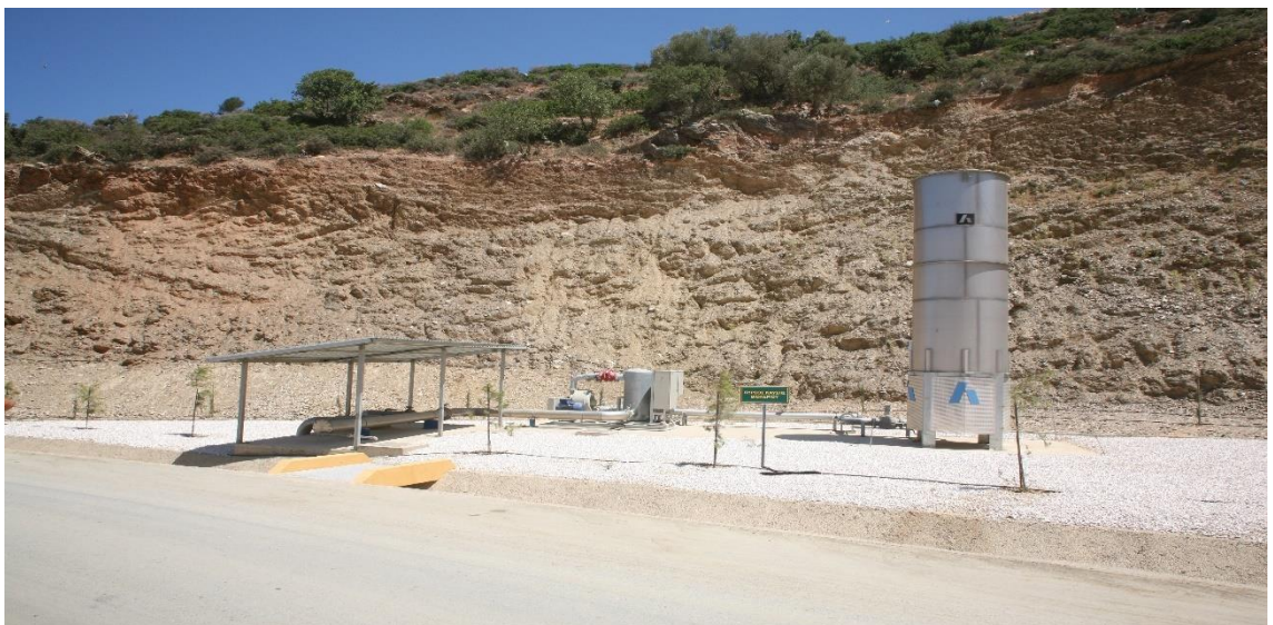
εικ. 23: Δίκτυο και πυρσός καύσης βιοαερίου στο ΧΥΤΑ Π. Γαλήνων (ΕΣΔΑΚ)
