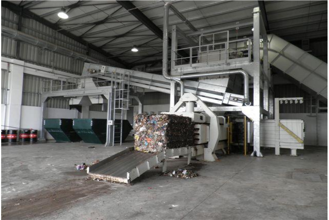
εικ. 7: Η Μονάδα προεπεξεργασίας Απορριμμάτων Ηρακλείου Κρήτης
