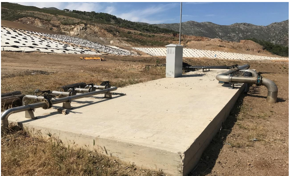
εικ. 34: Άποψη δικτύου συλλογής βιοαερίου στο ΧΥΤΑ Π. Γαλήνων
