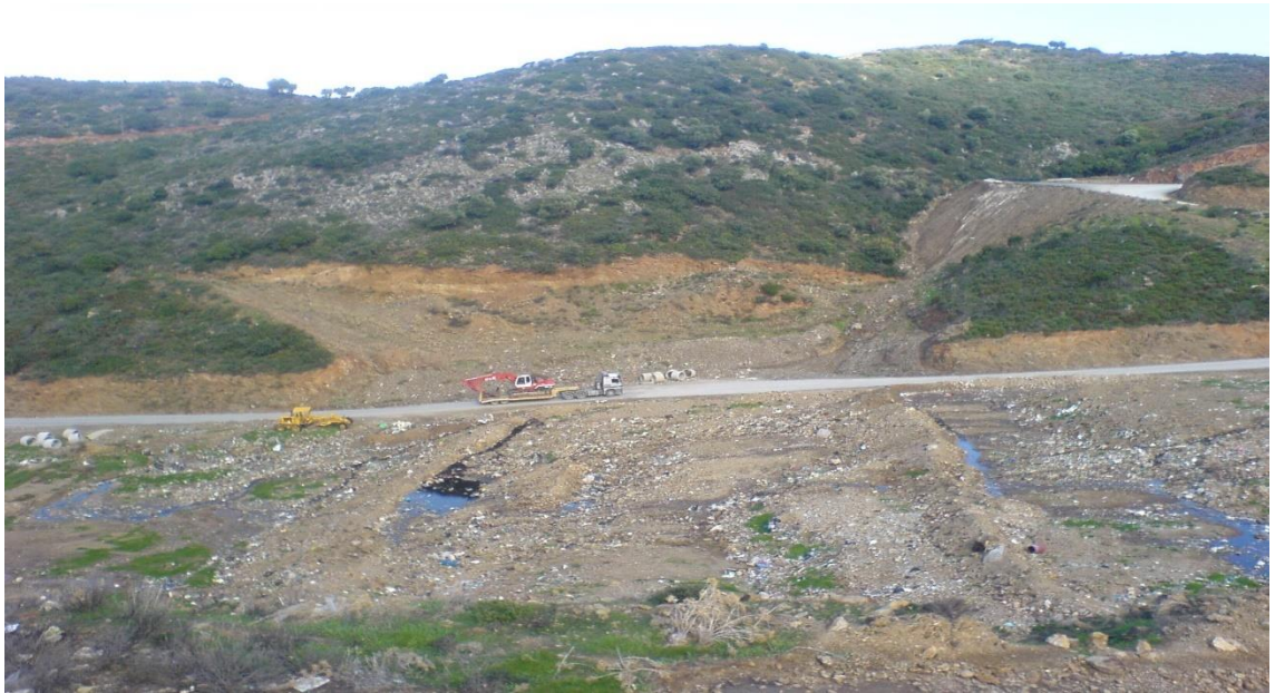
εικ. 19: Διαρροές στραγγισμάτων στο ΧΑΔΑ Π. Γαλήνων (ΕΣΔΑΚ)
