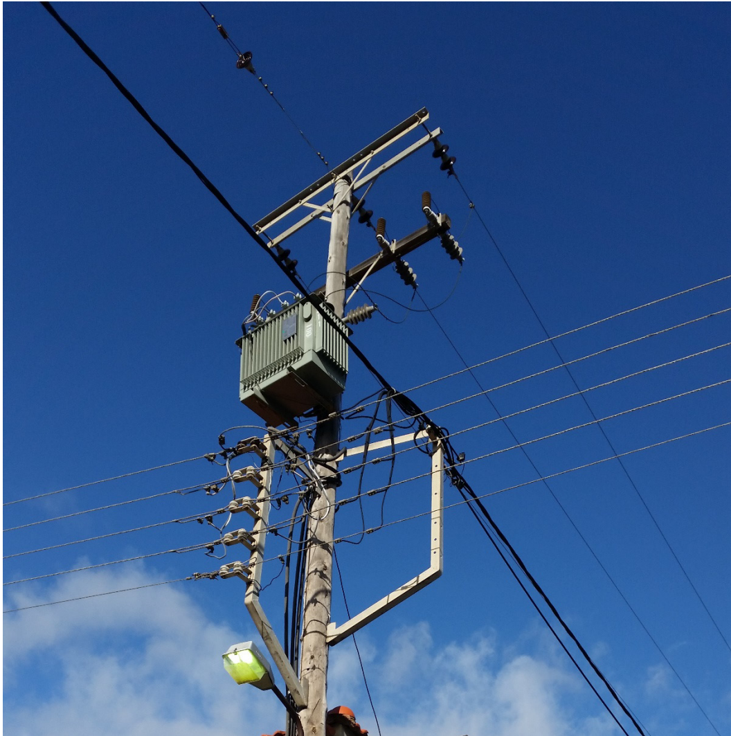
Σχήμα 6. Μετασχηματιστής Δικτύου Διανομής.
