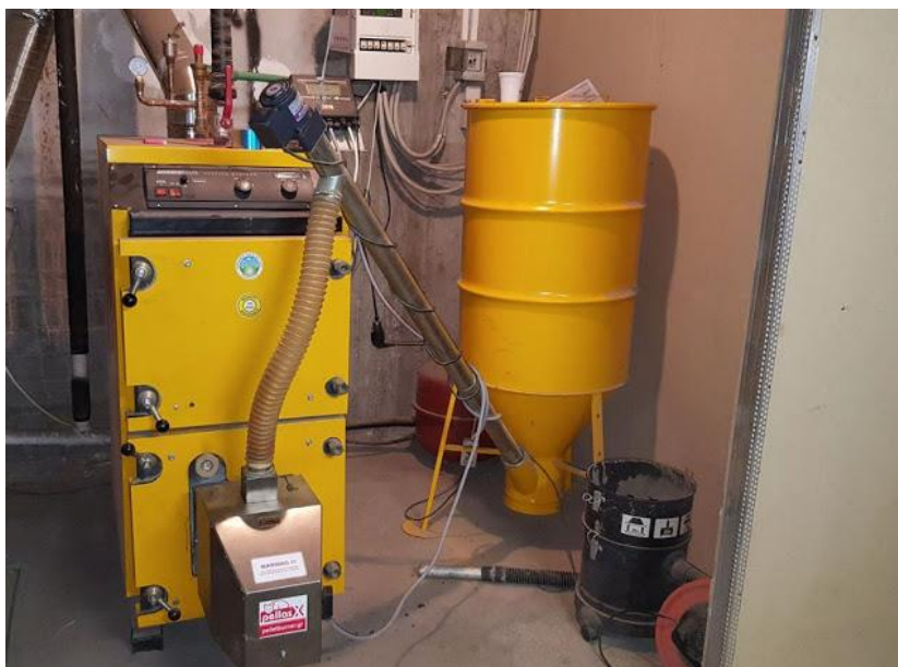
Εικόνα 40 Μετατροπή καυστήρα πετρελαίου σε πέλλετ (Πηγή http://thermansinews.blogspot.gr )
