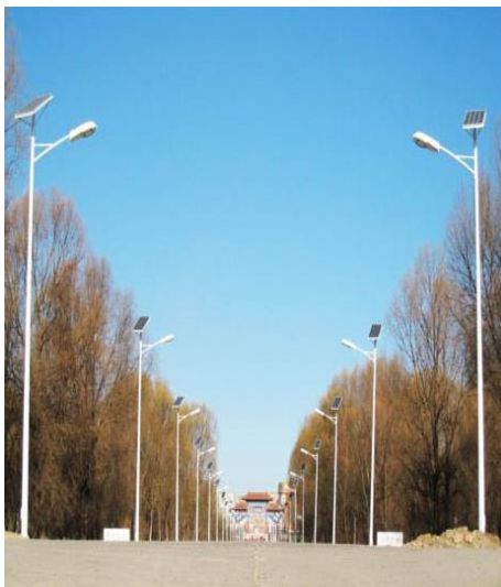
Εικόνα 34 Αυτόνομα φωτοβολταϊκά συστήματα φωτισμού οδών (Πηγή www.pvtech.gr )
