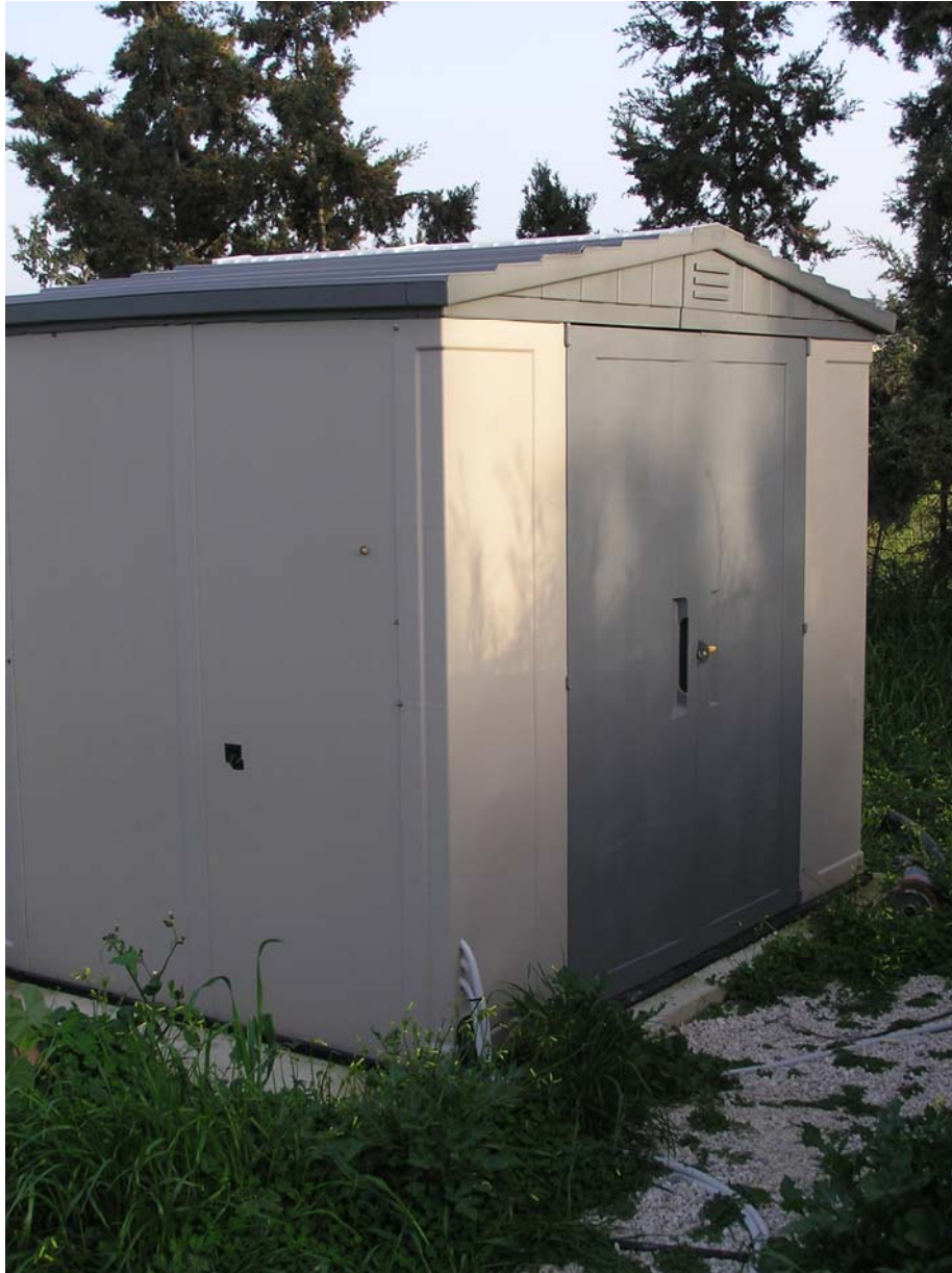
Εικόνα 11. Οικίσκος στέγασης αυτοματισμών λειτουργίας του υγροβιοτόπου.
