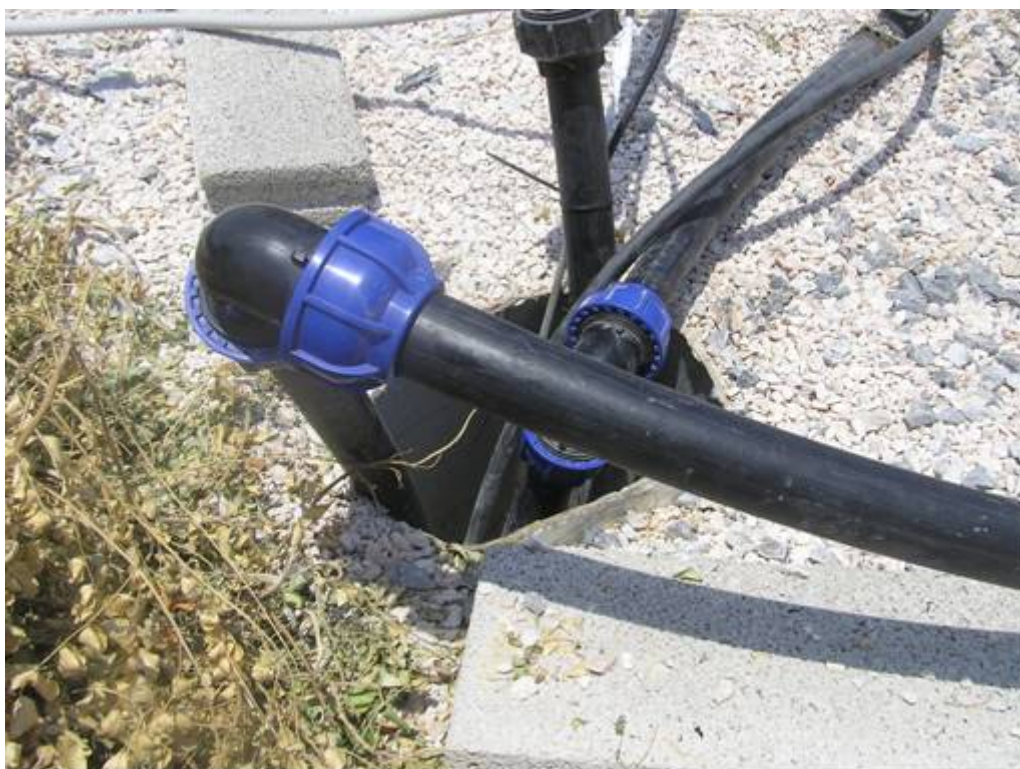
Εικόνα 2. Σύστημα αντλιών στην δεξαμενή απορροής.
