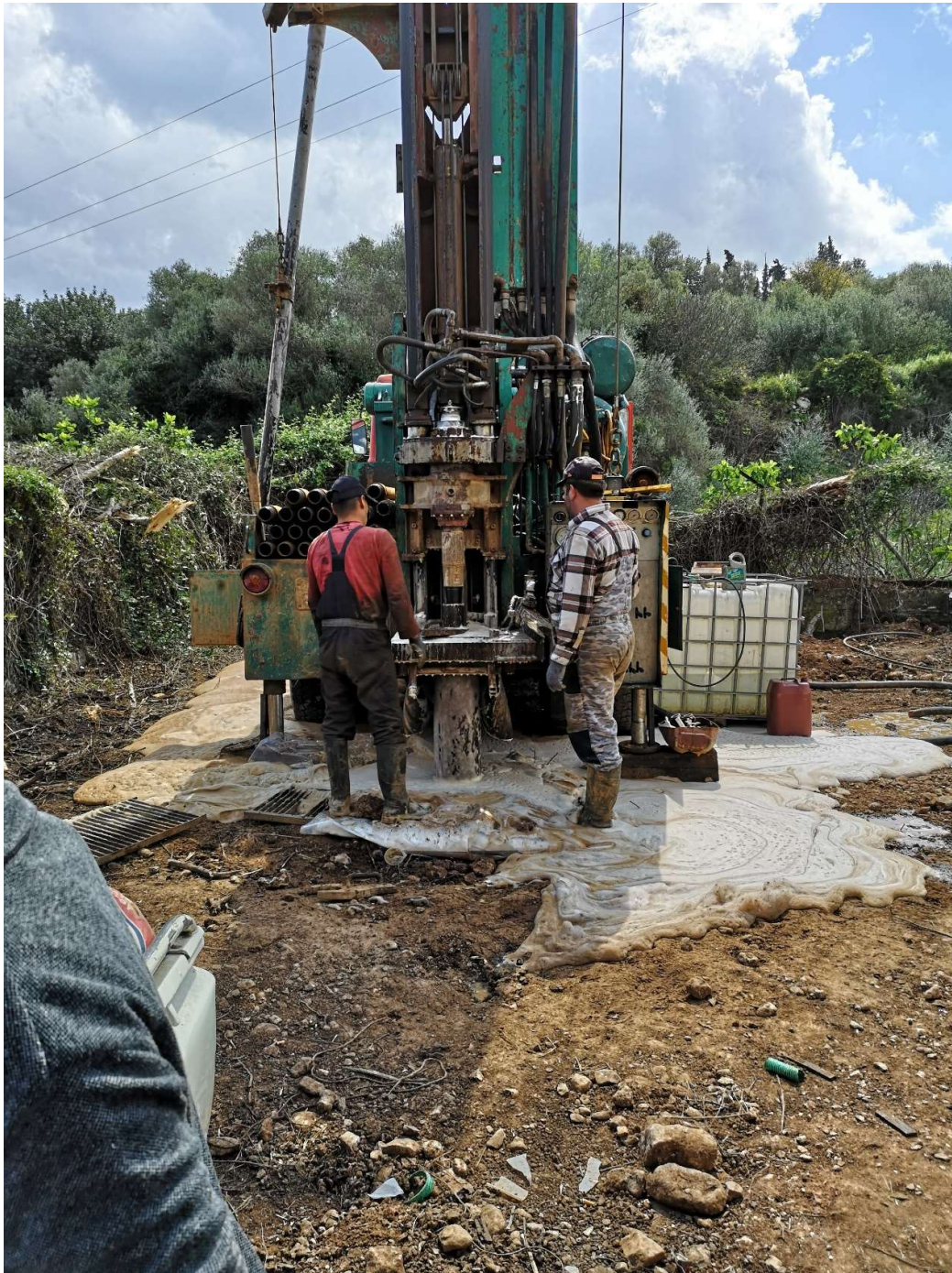
Εδώ φαίνεται η δεύτερη περιφραγματική σωλήνα η οποία τοποθετήθηκε ώστε να μην χρειαστεί η εγκατάσταση του μπετονίτη.
