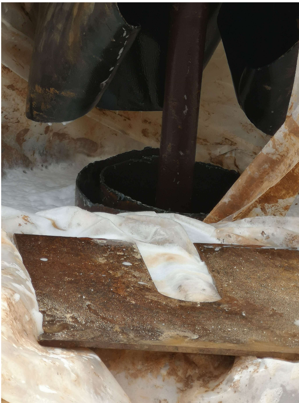
Οι δύο περιφραγματικές σωλήνες. 18,5 ιντσών και 16 ιντσών αντίστοιχα.
