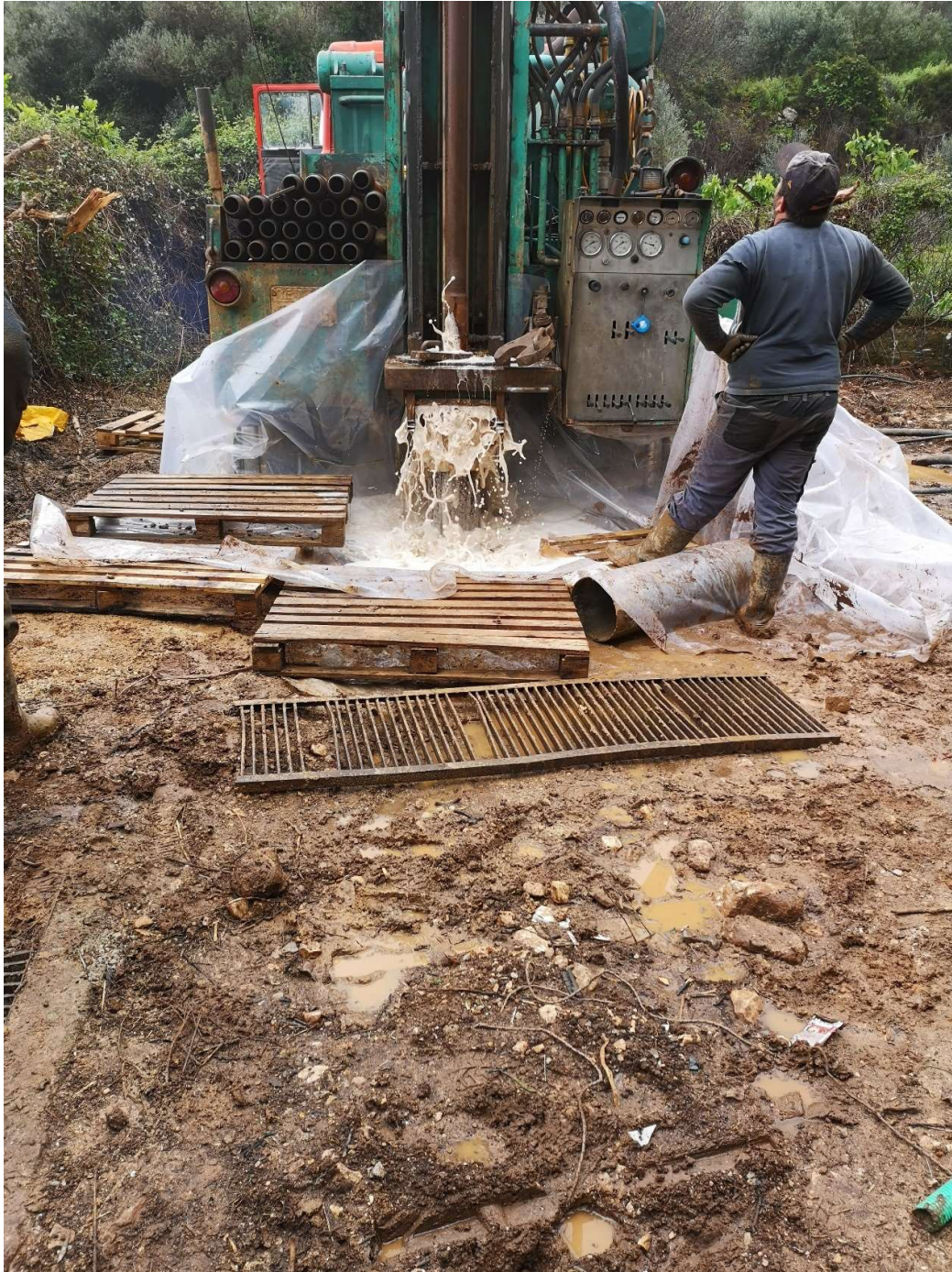
Αυξημένη ροή αφρού/νερού λόγω ύπαρξης νερού στο υπέδαφος.
