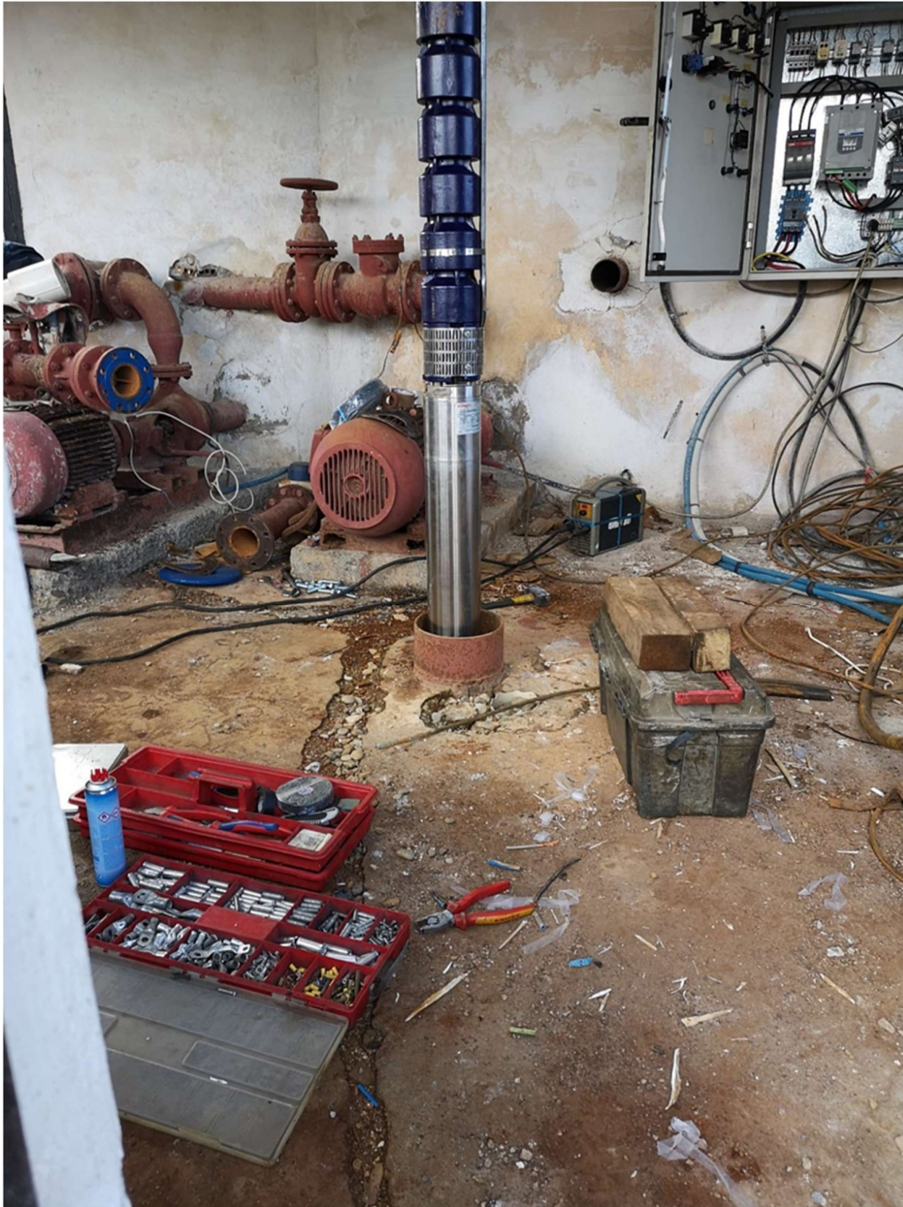
Αντλία με σωστά στοιχισμένα τα καλώδια τροφοδοσίας ρεύματος και information feedback.
