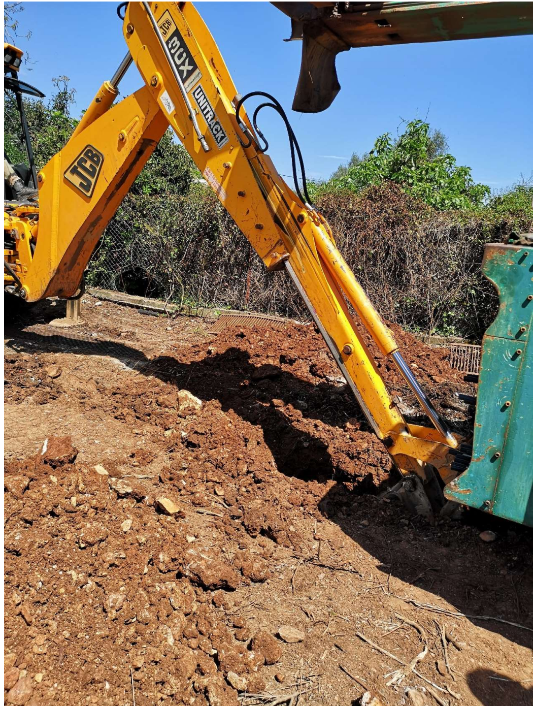
JCB ανοίγει την αρχική τρύπα όπου θα τοποθετηθεί ο περιφραγματικός σωλήνας για να ανοιχθεί η γεώτρηση.
