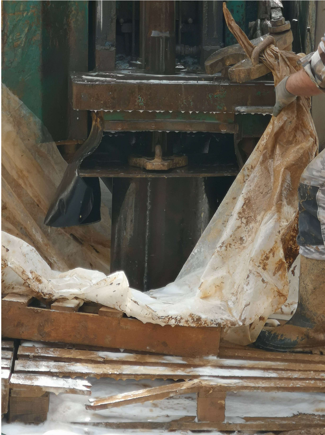
Προσπάθεια για καλύτερη τοποθέτηση της δεύτερης περιφραγματικής σωλήνας, δηλαδή να κατέβει βαθύτερα.
